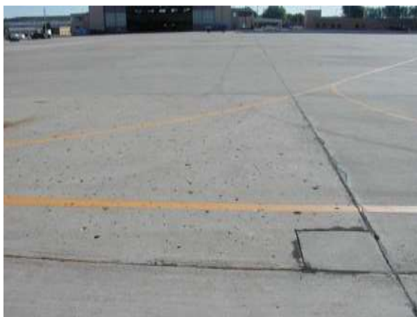
Figura 2.32 – Pequenos pedaços soltos do pavimento (FAA, 2009)
