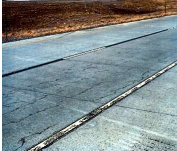
Figura 2.11 – Fendas de Retração (Pavement Interactive @2016)
