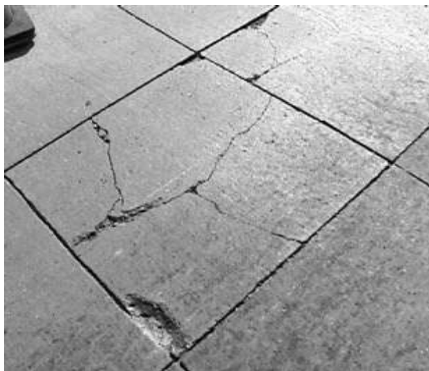
Figura 2.12 – Fendilhamento com perda de material (PaveMaintenance @2016)
