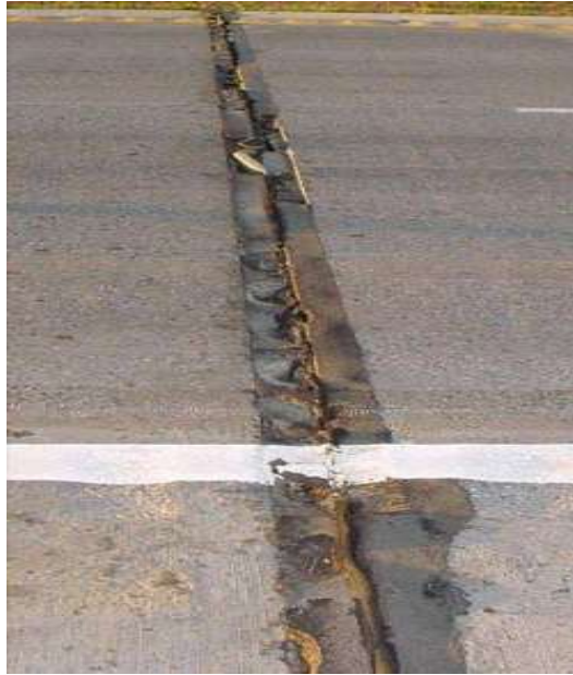
Figura 2.13 – Selagem das juntas deteriorada (Federal Highway Administration@2016)
