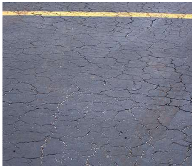
Figura 2.16 – Rede superficial de fendilhamento (Buildings @2016)
